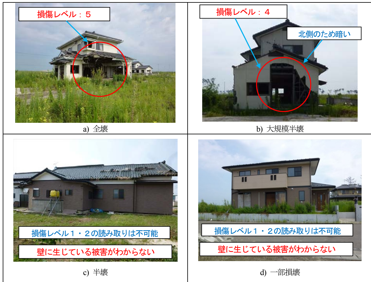
Fig.7 建物被害写真アップロードシステムを用いた全景写真
