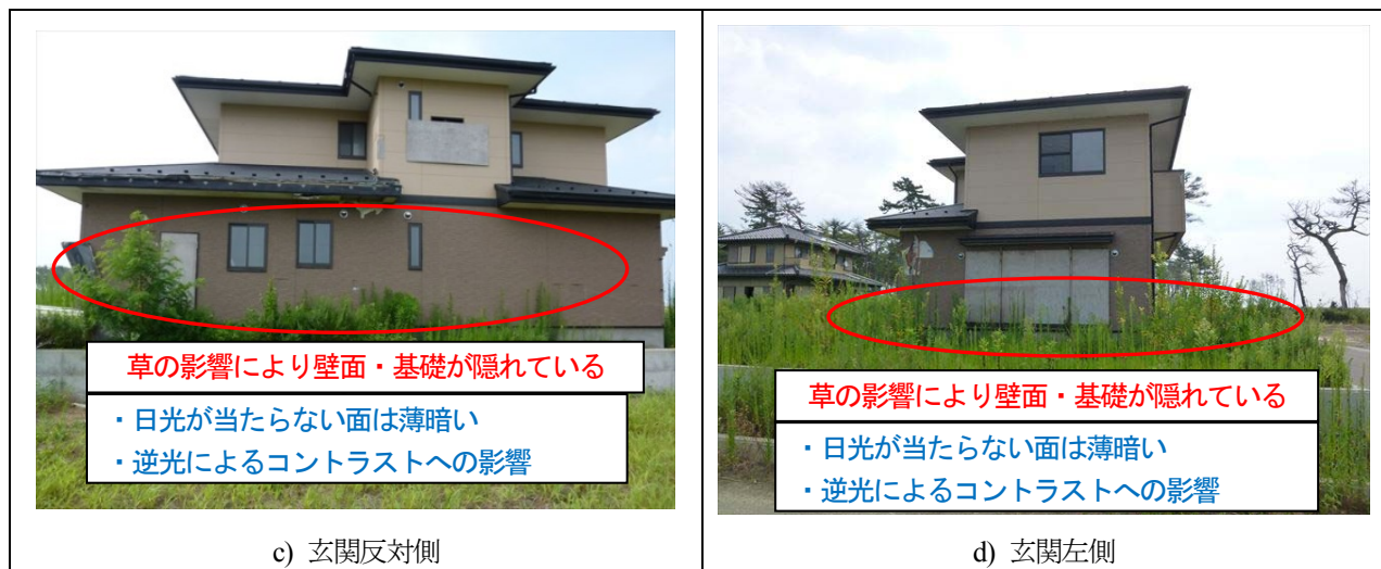
Fig.9 建物被害写真アップロードシステムを用いた全景写真 (2)
