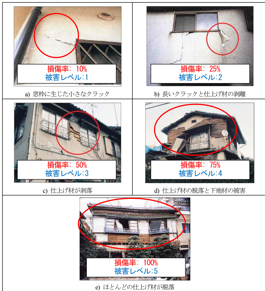
Fig.3 壁の被害と損傷率・被害レベルの関係 7)
