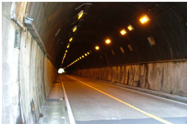
Fig. 1 対策前のトンネル写真
