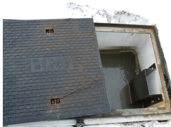
Photograph 19 同地区集積所に敷設の油水分離槽
