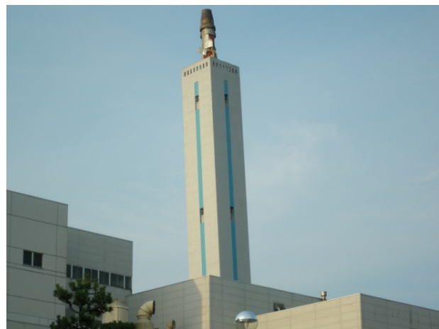
Photograph 2 RC製煙突破損 (2007年7月19日撮影)
