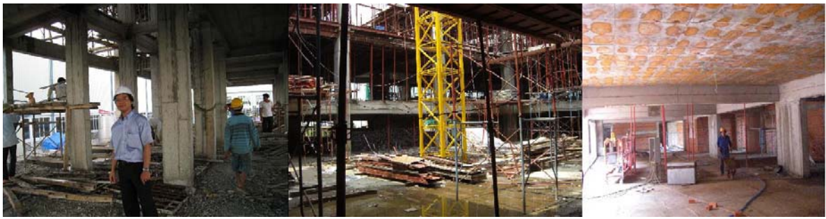
Fig. 5 現場での材料保管倉庫がない為型枠錆びによる天井錆び
